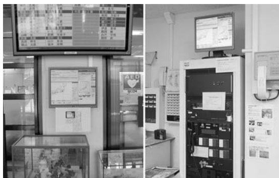
Fig.1 緊急地震速報表示モニタ (左：ロビー, 右：学内放送用設備上)
