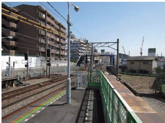
資料28 西谷駅と横浜羽沢駅間を結ぶ新線の工事が進められている。
