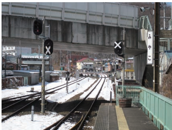
資料3 JR東日本と三陸鉄道の共同使用駅である宮古駅構内に設置されているJR所有の出発信号機(左側)と三陸鉄道所有の出発信号機(右側)。使用不能になっている信号機には×印のテープが貼られているが、それぞれの会社が自社の信号機に×印を付けたため、微妙な違いがあることが分かる。
